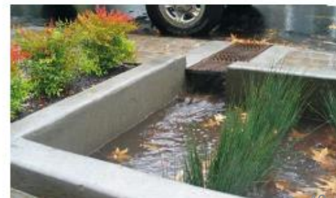
Abb 27 Zuleitung wenig belasteter Straßenabflüsse in ein Tiefbett
