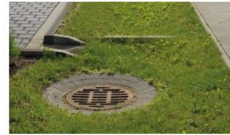
Abb 24 Dezentrale Straßenentwässerung über Muldenkaskaden
